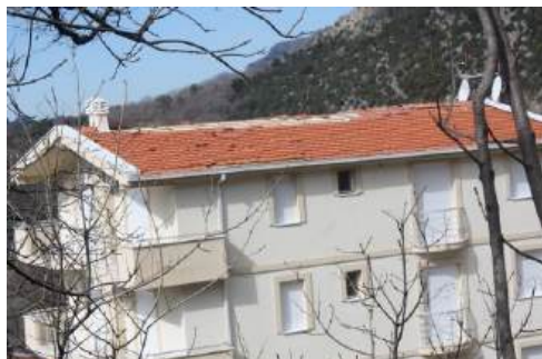
Повреждённая ураганом крыша гостиницы в Бырце
